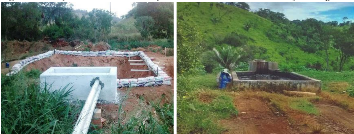
Figura 23. Estação de Tratamento da empresa coletora de resíduos dos serviços de esgotamento.
