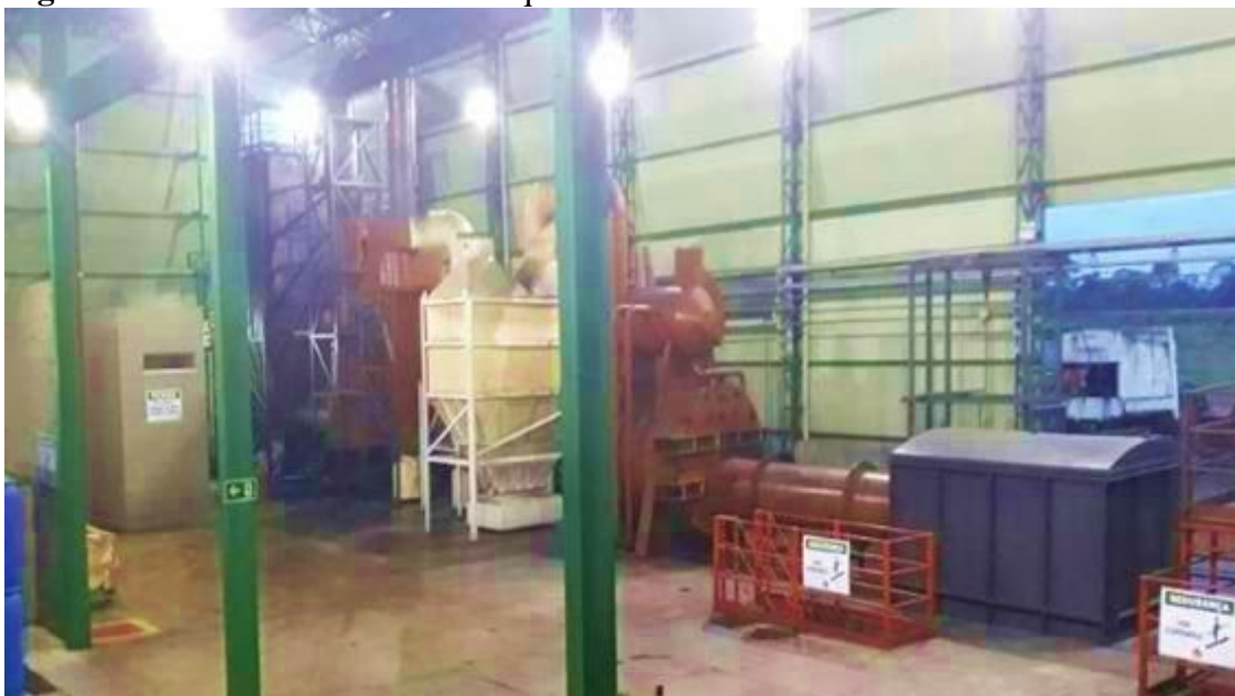
Figura 31. Incinerador utilizado na queima dos RSS.
